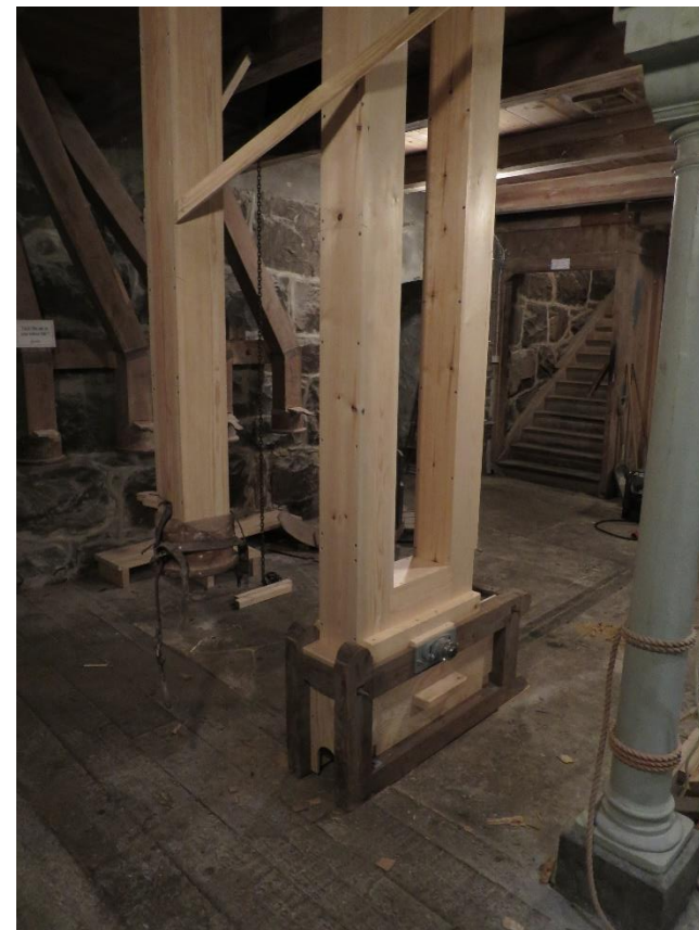
Botten av den nyrenoverade elevatoren i källaren.
